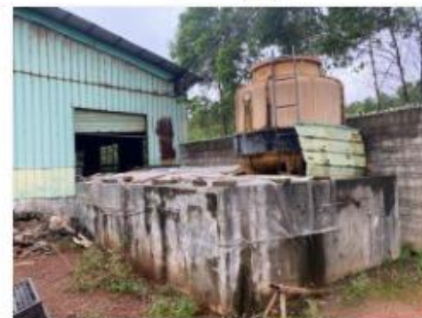
冷却池及水泵.jpg
