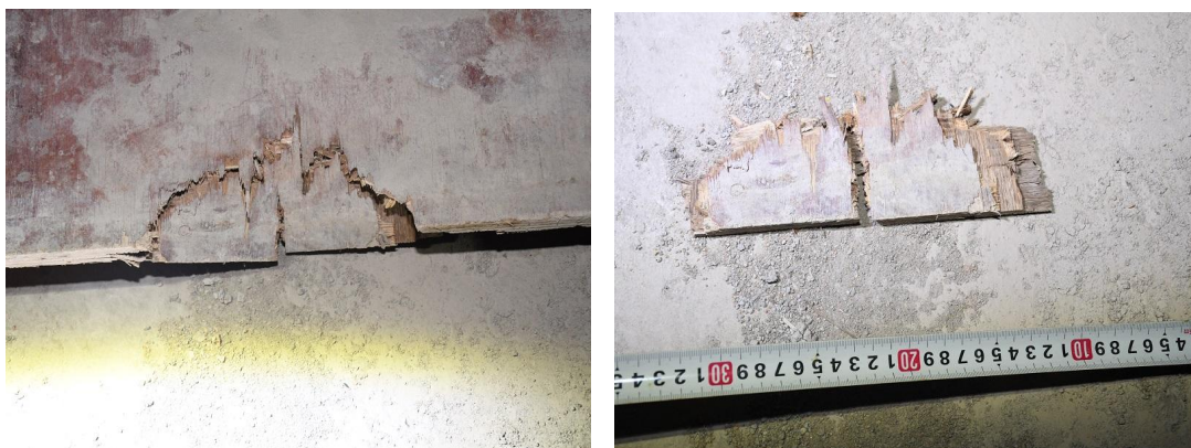
图 11-1 六楼层站入口通道的模板开裂情况
