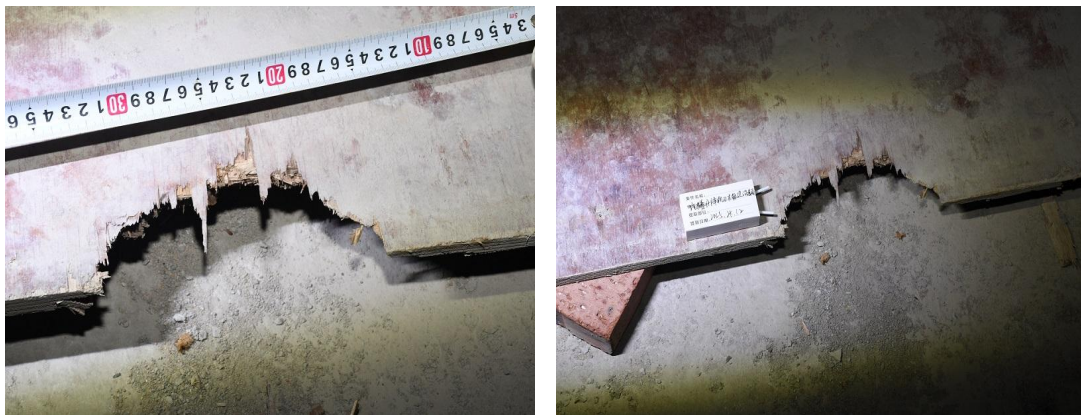
图 11-2 六楼层站入口通道的模板开裂情况
