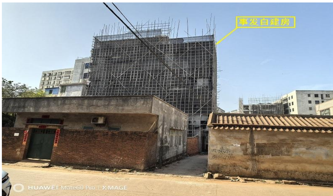
图 3 事发自建房南向视角外观
