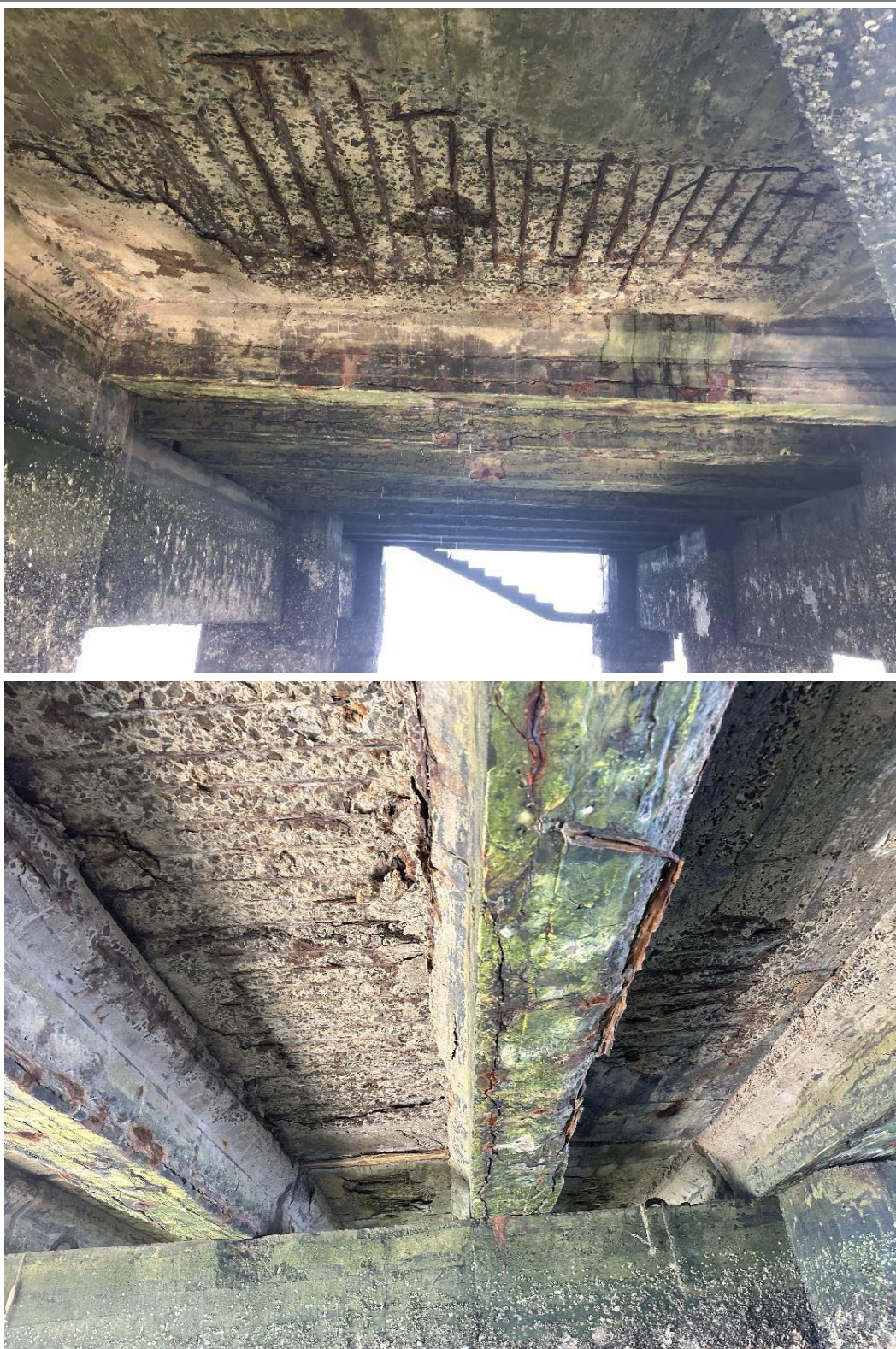
图 1.6.2-2e 流沙港渔业码头主体结构现状照片（钢筋裸露锈蚀）
