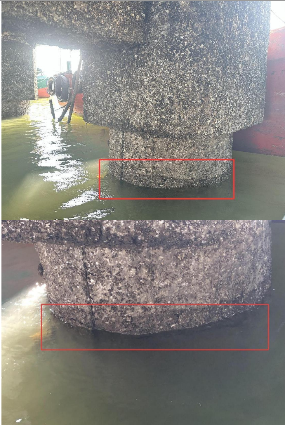
图 1.6.2-2b 流沙港渔业码头主体结构现状照片（桩基断裂）
