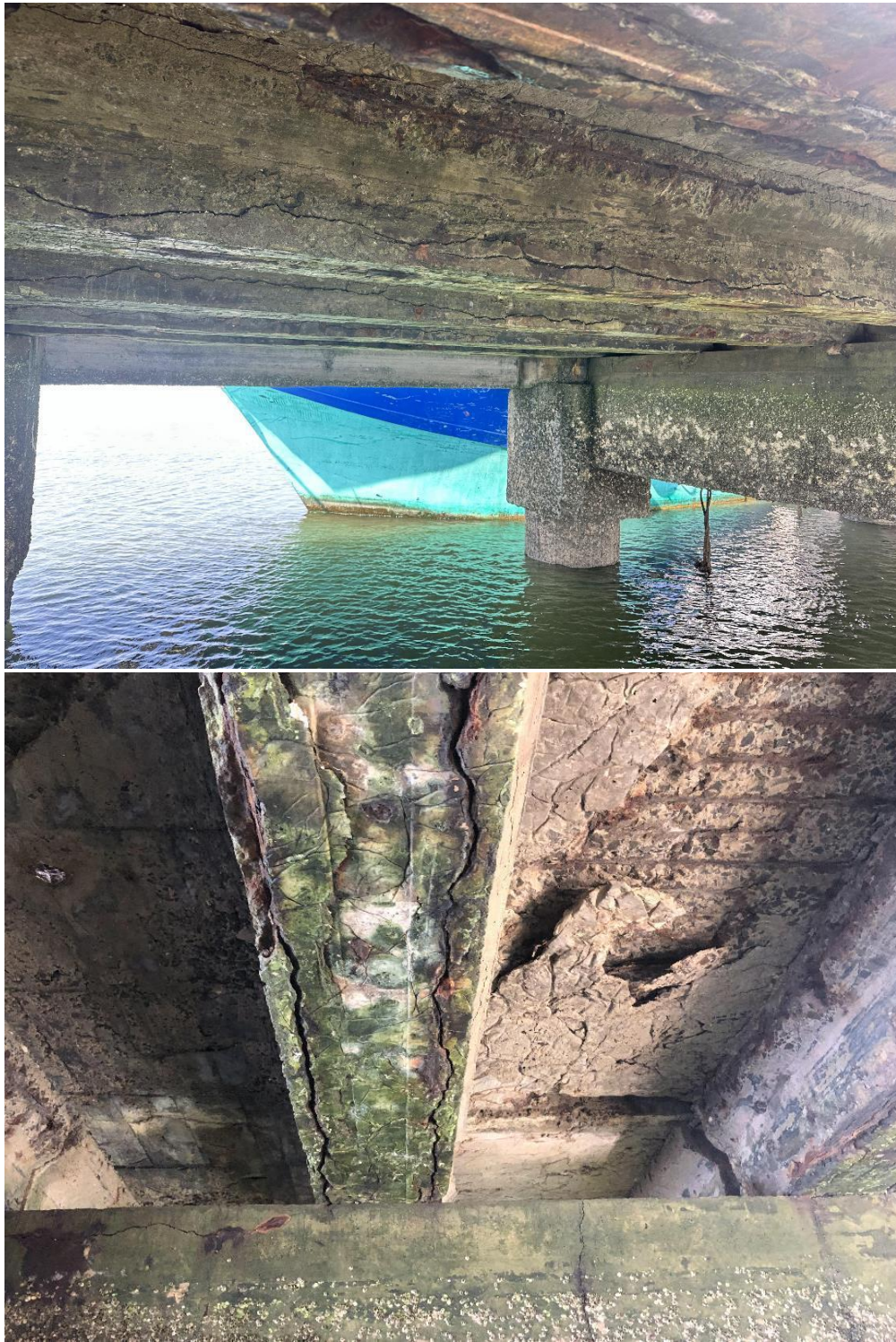
图 1.6.2-2c 流沙港渔业码头主体结构现状照片（保护层开裂、脱落）
