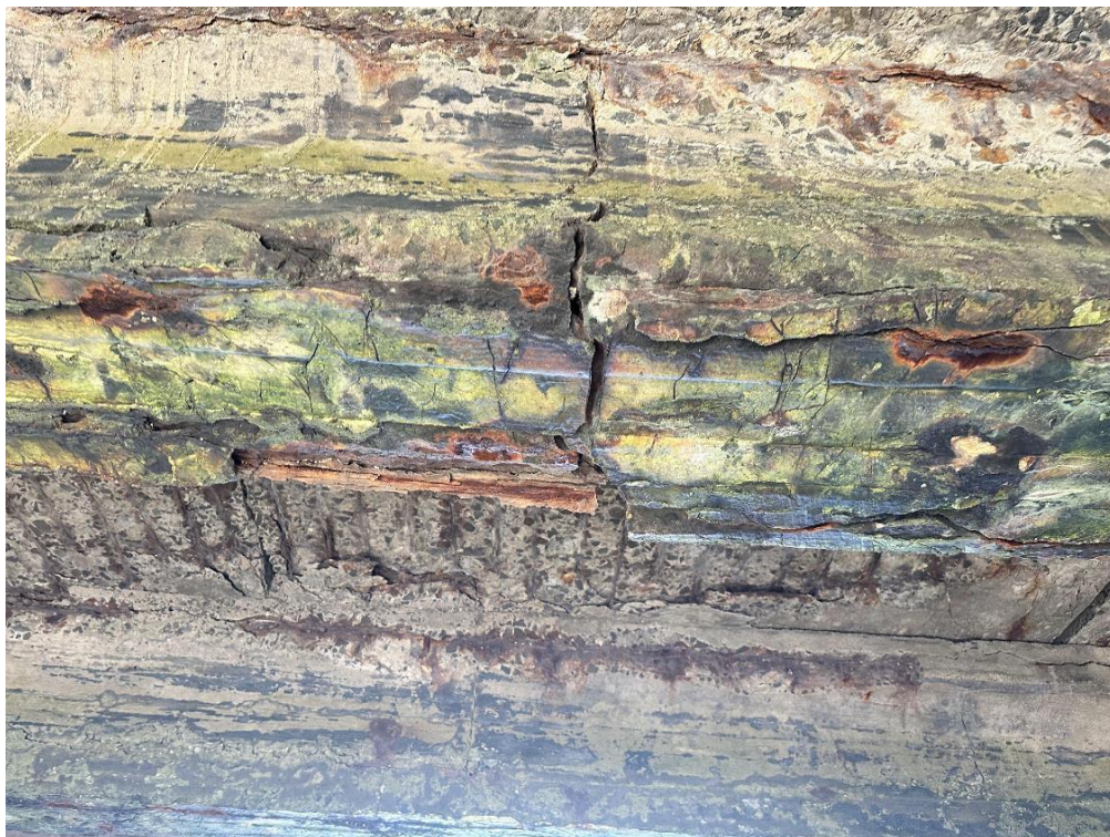
图 1.6.2-2d 流沙港渔业码头主体结构现状照片（纵梁断裂）
