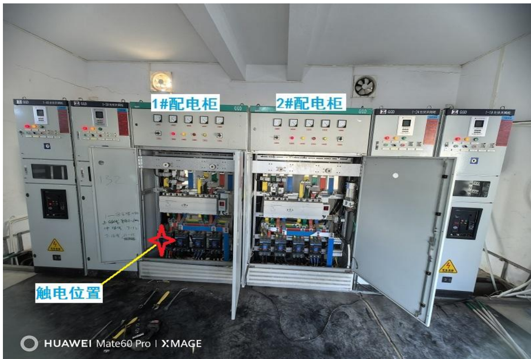
图 6 低压配电室室内情况
