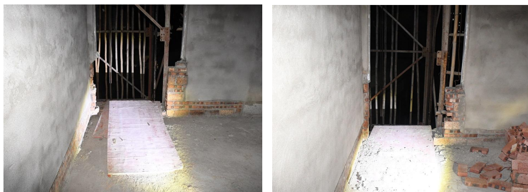
图 6 升降机层站入口情况
