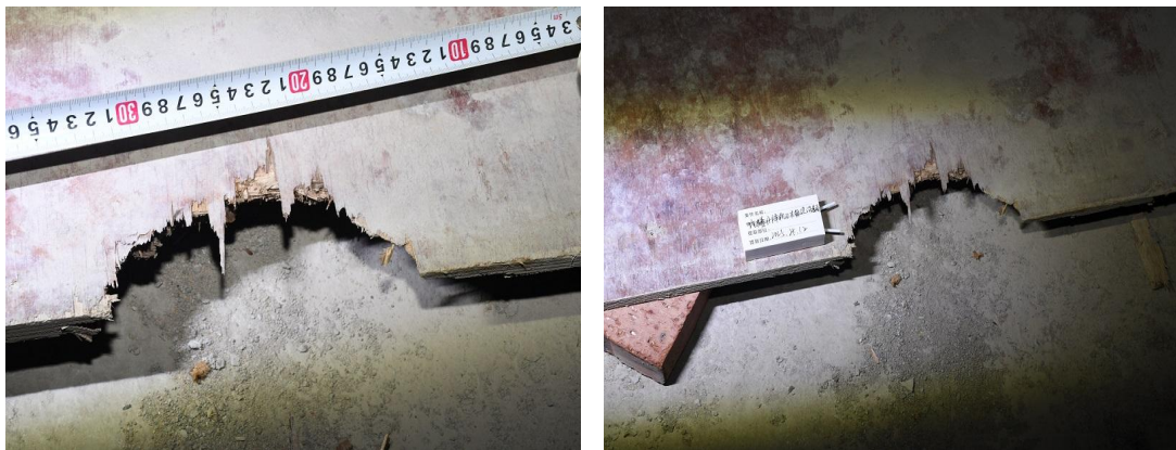
图 11-2 六楼层站入口通道的模板开裂情况
