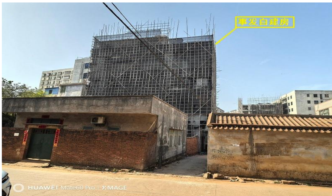
图 3 事发自建房南向视角外观
