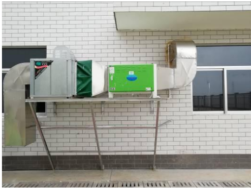
升压站现状除油烟装置
