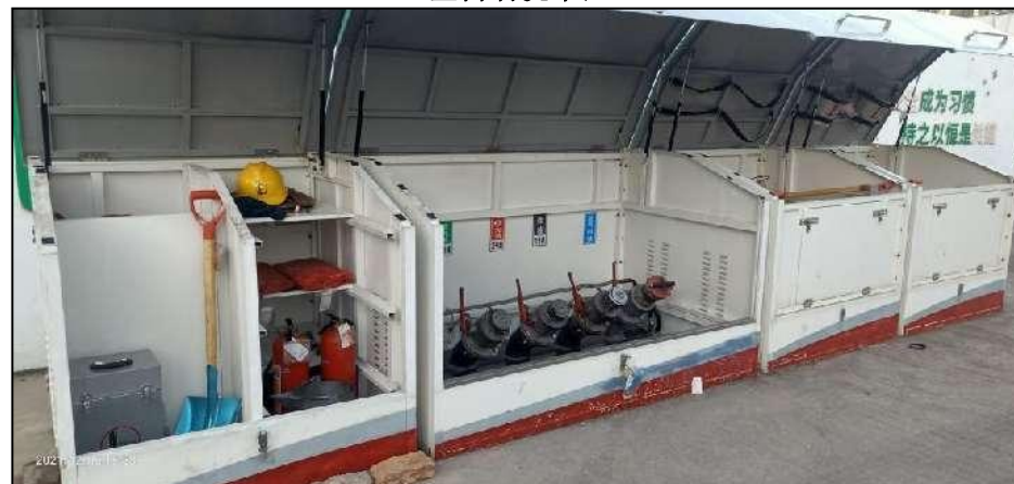
卸油口、消防沙、消防柜
