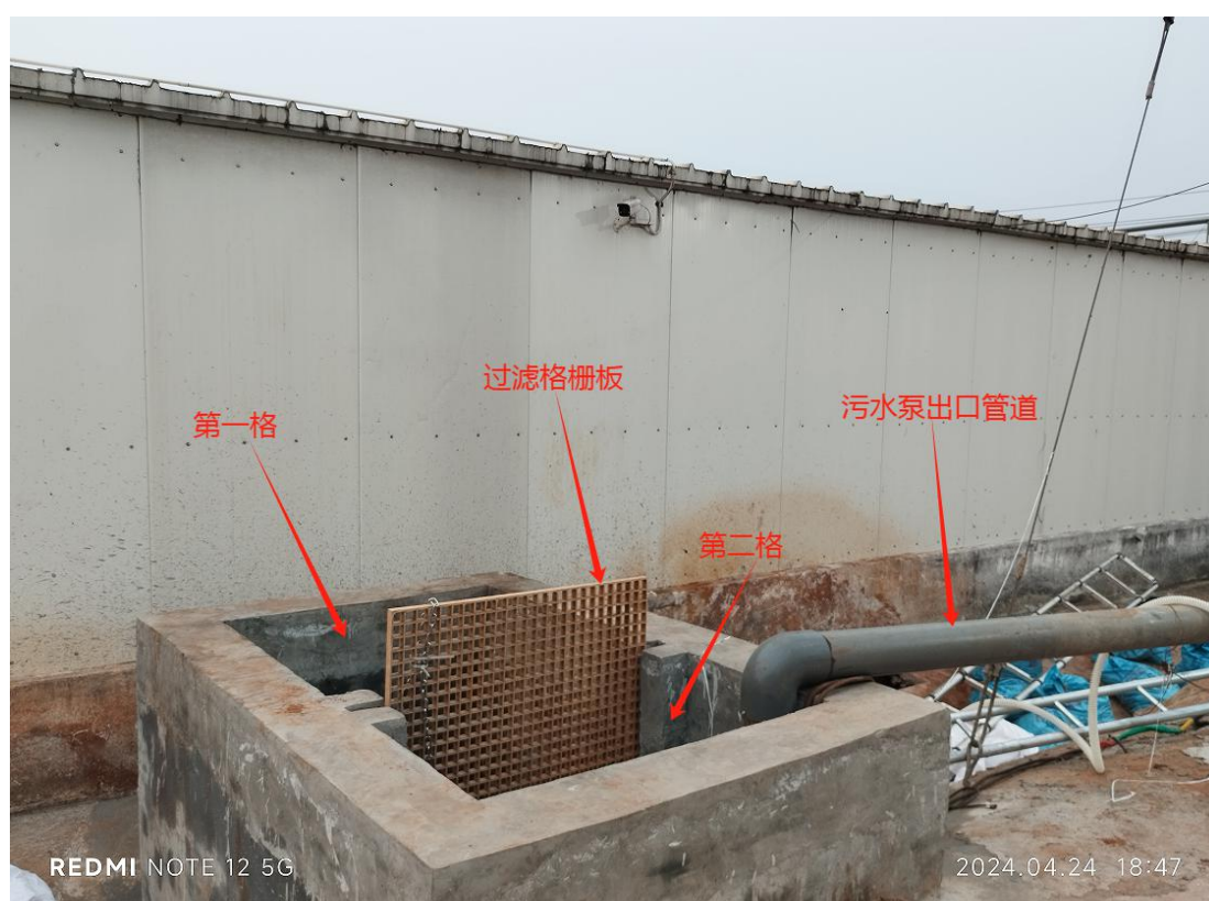
图 5 事发中转过滤池外观情况
